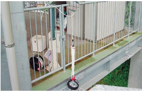
避難タワーに設置された緩降機
